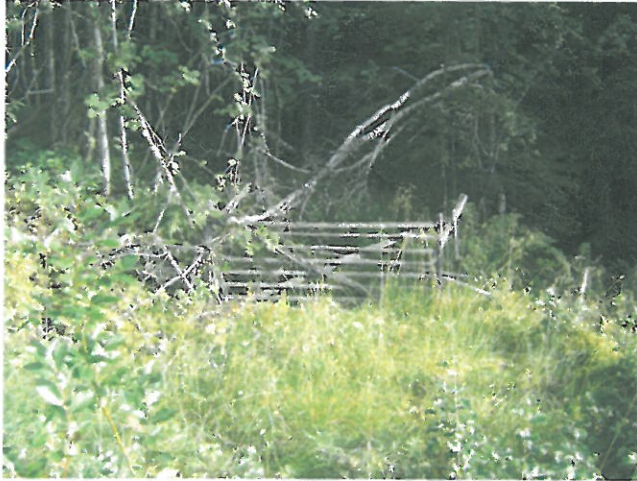
Figur 50. Grindene bør skiftes ut
