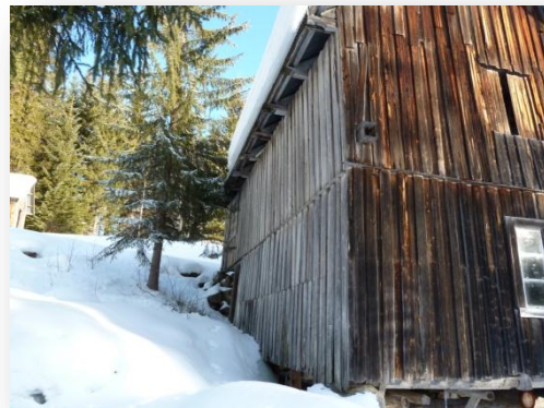
Treet står for nær huset og må fjernast.
