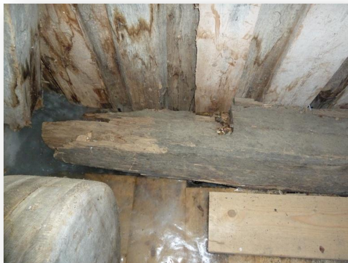
Råte i svilla mot nord.
