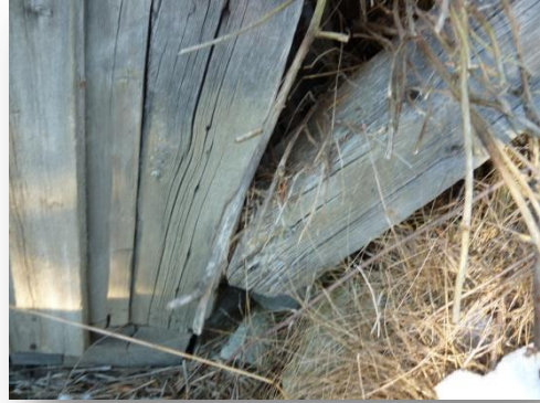
Skråspennet må få bedre hald i stolpen.
