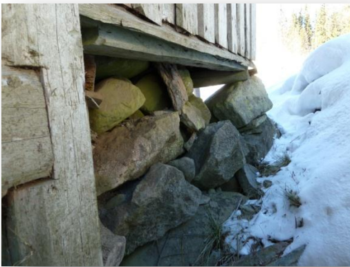
Hjørnesteinen er ustabil og må sikrast. Resten av muren på bilete er for turkepanna og har ingenting med veggen å gjera.
