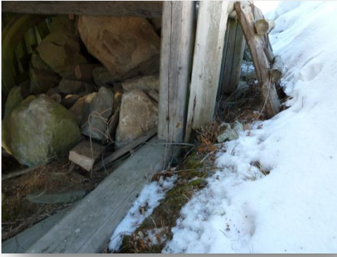
Truleg er det råte i bæringa her, slik at ei utskifting kan vera nødvendig.
