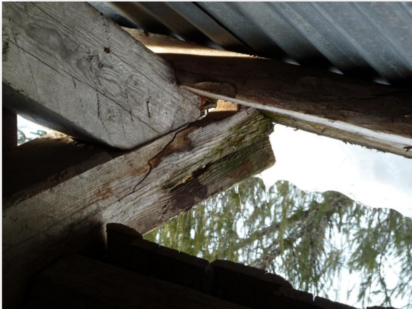
Det er råte i nokre av sperre – endane.
