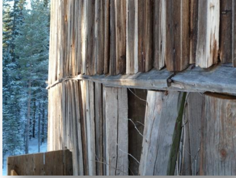
Veggen heng i både hjørne og må jekkast opp.
